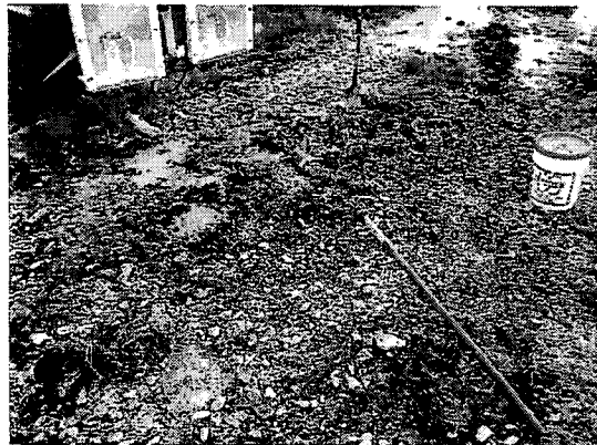
Photo 5 surface où se trouvait le béton
