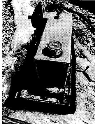
Photo 4 - Seconde pompe pour la prise d'eau. Bacs de récupération de diesel plein d'eau.
